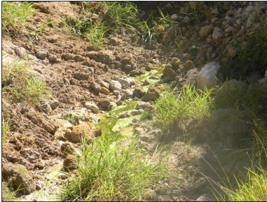
Figura 3: Curso d'água no interior da voçoroca. Paredes laterais solapadas por intemperismo físico-químico, CVP-39.
