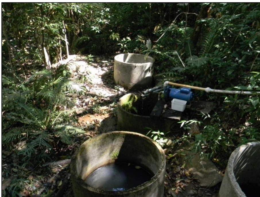
Figura 3: Poços de captação de água proveniente da nascente CVP-24.
