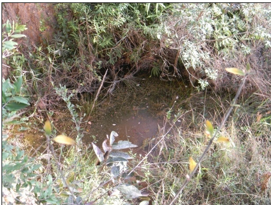
Figura 3: Afloramento hídrico no interior da voçoroca, solo argilo-siltoso, ponto CVP-29.
